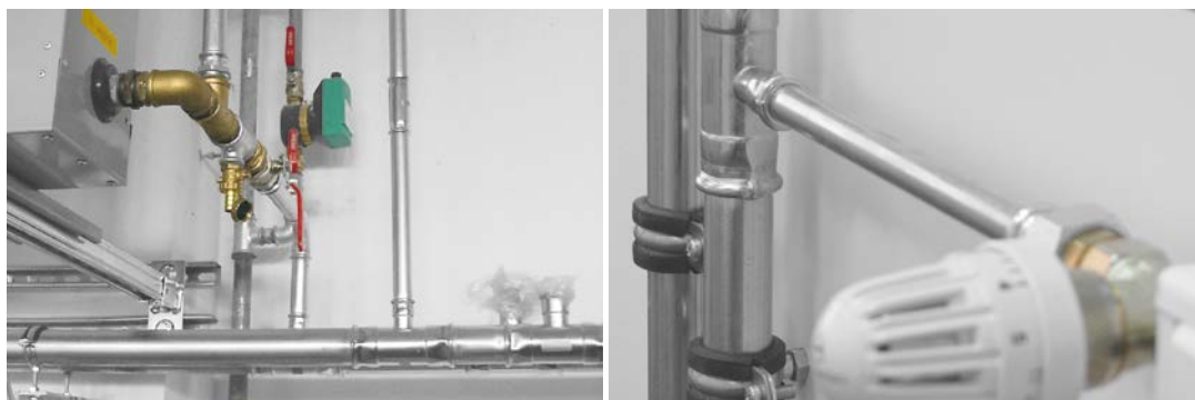
Примеры монтажа оборудования KAN-therm Steel
